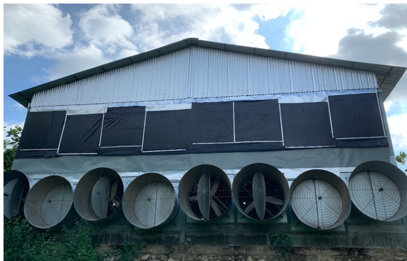
Gambar 19. Exhaust fan kandang ayam broiler tampak sisi luar (Dok. Penulis, 2023)
